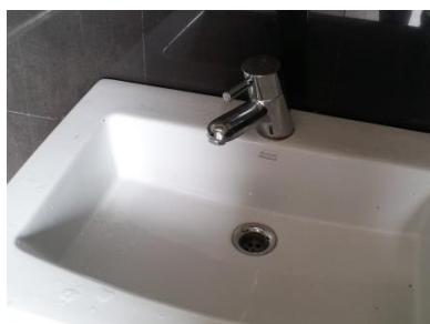
4) เมื่อเข้าไปใช้งานจริงจึงพบว่าอุปกรณ์ต่างๆ เกิดการชำรุด เช่น ก๊อกน้ำหลวม
