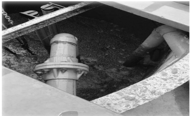
รูปที่ 2ข ท่อดูดของเสียภายในบ่อพัก
